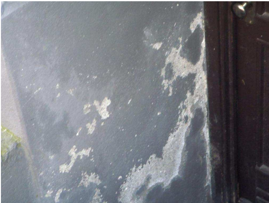
Afskallet puds på underfacade.
