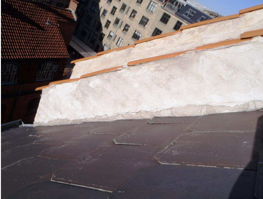
Inddækning/fuge ved brandkam er revnet.
